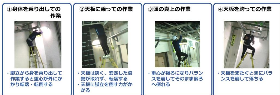
（図1）脚立作業における危険状態の例（安全に配慮して撮影）
